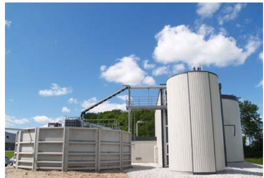
Tannergård Biogas, et gårdbiogasanlæg.
